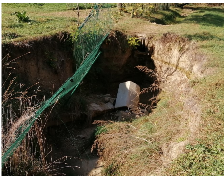
Fotó: Árokkimosódás ugyancsak a Téglagyári utcában
